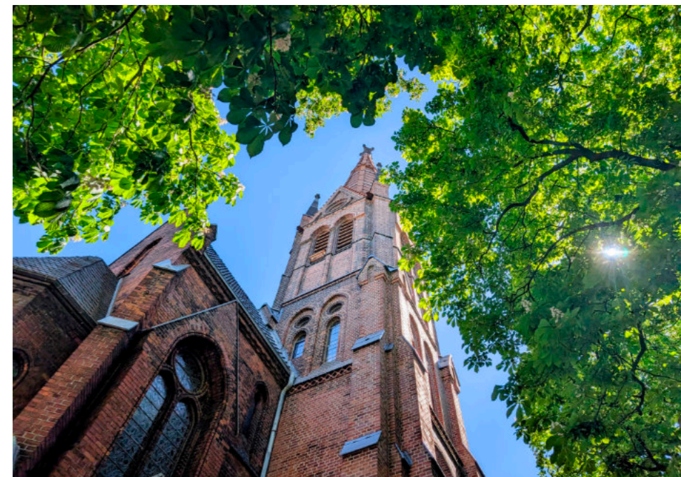
Wieder joot in Schuss: der Turm der Lutherkirche nach den Renovierungsarbeiten. Foto: S. Züger
